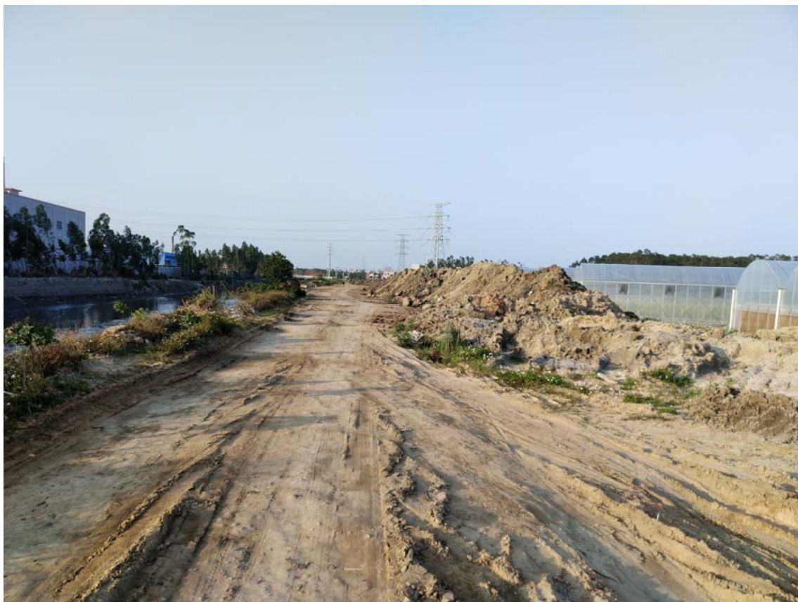
照片 27 港塔溪清淤（5#监测点），淤泥堆放已破坏本项目绿化
