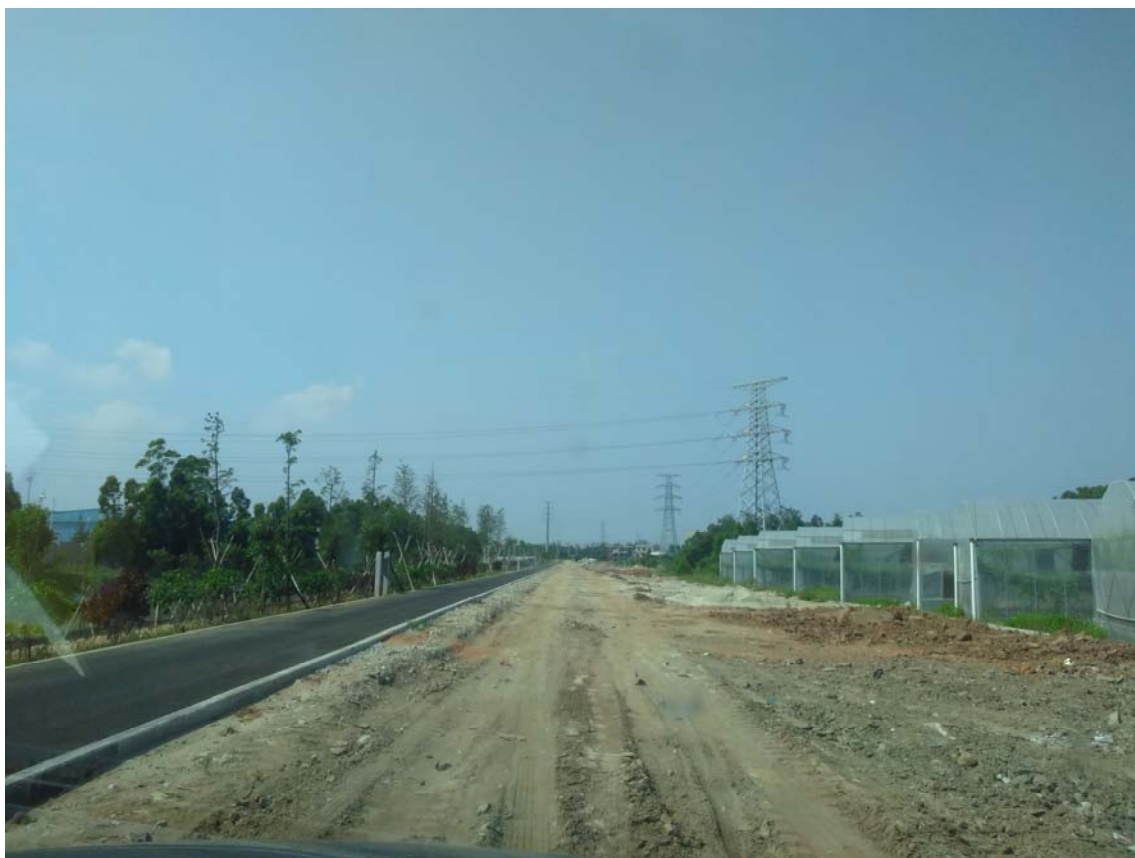
照片 28 港塔溪清淤（5#监测点），淤泥运走后植被未回复，建议尽快协调绿化
