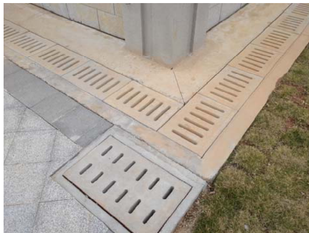
泵站区排水设施及绿化
